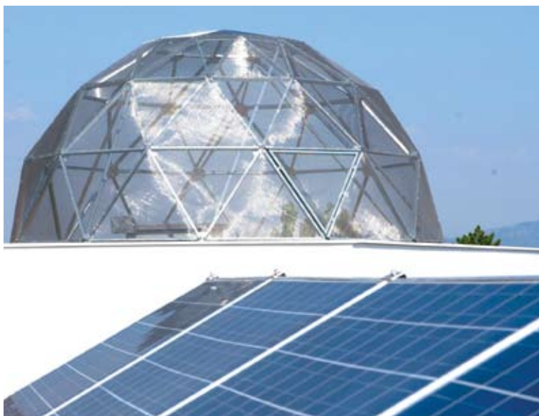
Les 310m 2 de capteurs photovoltaïques installés sur le toit de la médiathèque Françoise Giroud à Castries permettront de réaliser une recette annuelle de 18 000 euros par an en revendant la production électrique obtenue à EDF.
