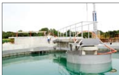
Station d'épuration de Saint-Drézéry
