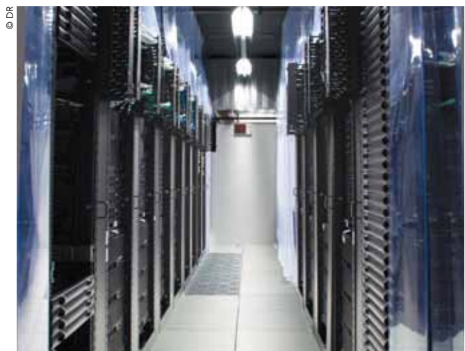
Les serveurs du Centre Cloud sont destinés à héberger les données des clients d'IBM, des PME et des collectivités locales.
