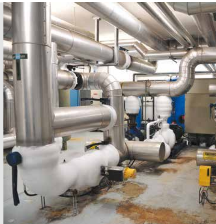
Dans la station de froid de Vegapolis, près de 150 m 3 d'eau maintenue à - 12°C et sportive à un débit de 180 m 3 /heure pour maintenir la glace en état.
