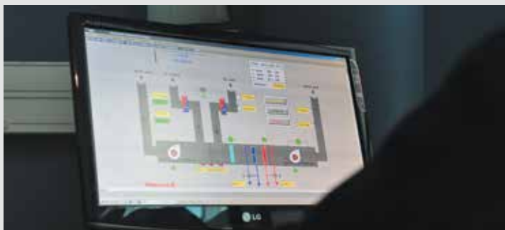
La station de froid et les centrales d'air sont contrôlées au quotidien par ordinateur.
