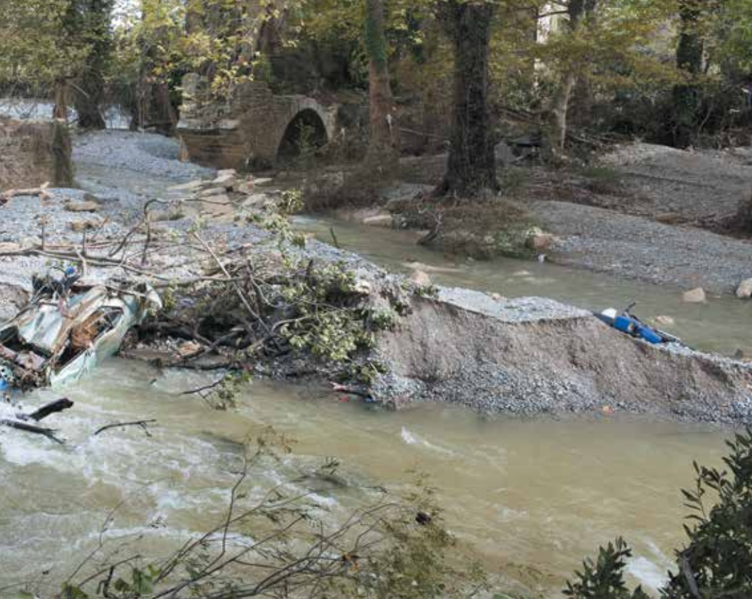
Le pont roman du XII e siècle entre Juvignac et Montpellier, sur la Mosson, a perdu une arche, emportée par les flots.
