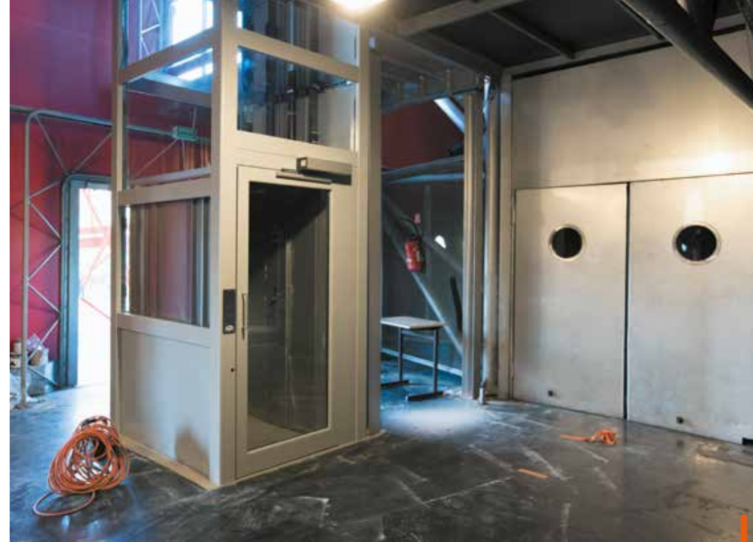
Grâce à un ascenseur, les personnes à mobilité réduite sont accueillies sur un nouvel emplacement à hauteur de la régie.
