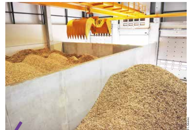
La centrale trigénération de Port-Marianne à Montpellier fonctionne à l'aide de granulés de bois.
