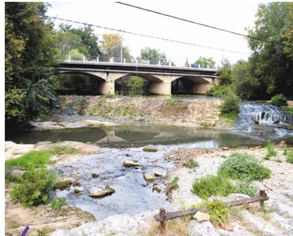
Le seuil du point du jour, à Juvignac, dégradé par les crues successives de La Mosson sera réaménagé.
