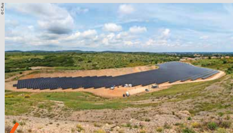
Le champ de panneaux photovoltaïques de la carrière de Courmonsec produit les 2/3 de l'énergie consommée par la commune.
